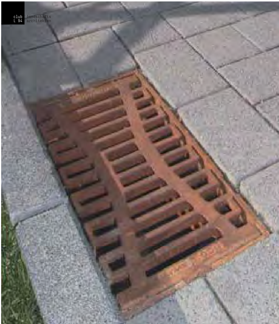
Hochborde mit Straßenabläufen
