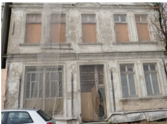
Abbildung 27: Abgängiges Wohngebäude Janup
