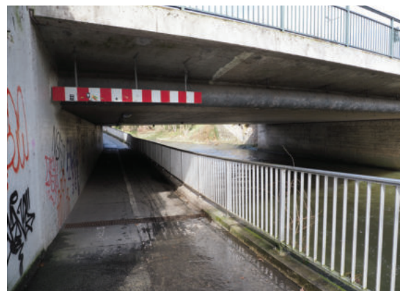
Abbildung 15: Unterführung am Wallring mit hohem Aufwertungsbedarf
