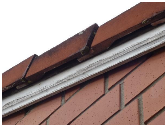
Abb. 19 Spalten an den Ortgängen von Gebäude 1.
