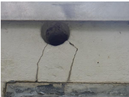
Abb. 42 Loch an der Südseite von Gebäude 7.
