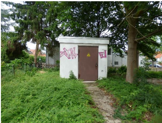
Abb. 8 Trafohaus im Plangebiet.
