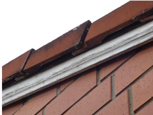
Abb. 16 Spalten an den Ortsgängen von Gebäude 1.
