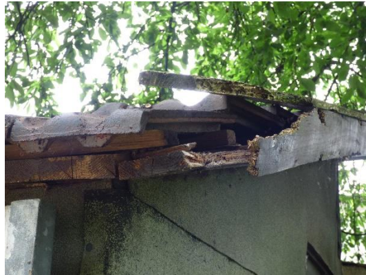
Abb. 23 Defekter Dachüberstand und Zwischenraum am Dach von Gebäude 3.
