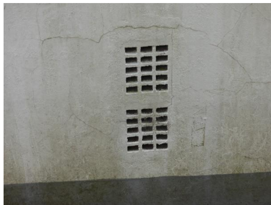
Abb. 40 Lüftungsspalten an der Südseite von Gebäude 7.
