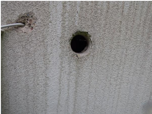
Abb. 21 „Lüftungsloch“ an Gebäude 2.
