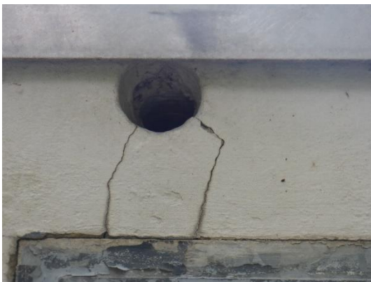
Abb. 39 Loch an der Südseite von Gebäude 7.
